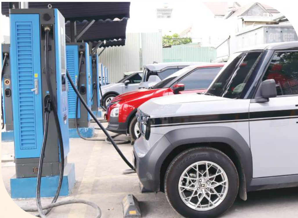
Hệ thống trạm sạc xe điện trên địa bàn phường Tam Hiệp, thành phố Đồng Nai.
