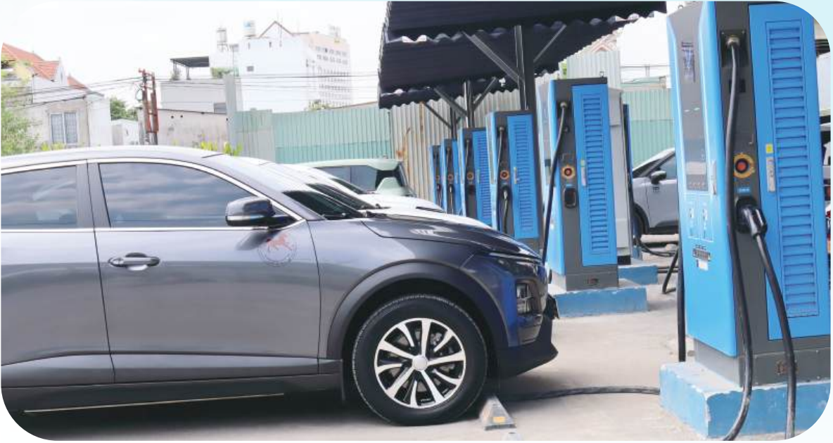
Một hệ thống trạm sạc xe điện tại phường Tam Hiệp, thành phố Đồng Nai.
