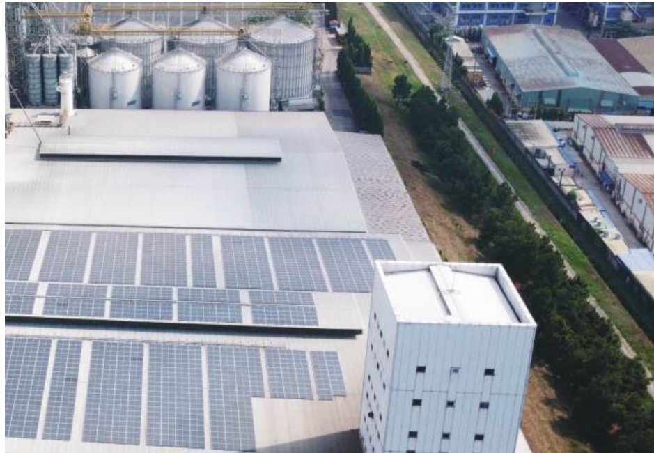
Hệ thống điện mặt trời mái nhà tại một doanh nghiệp ở Đồng Nai.
