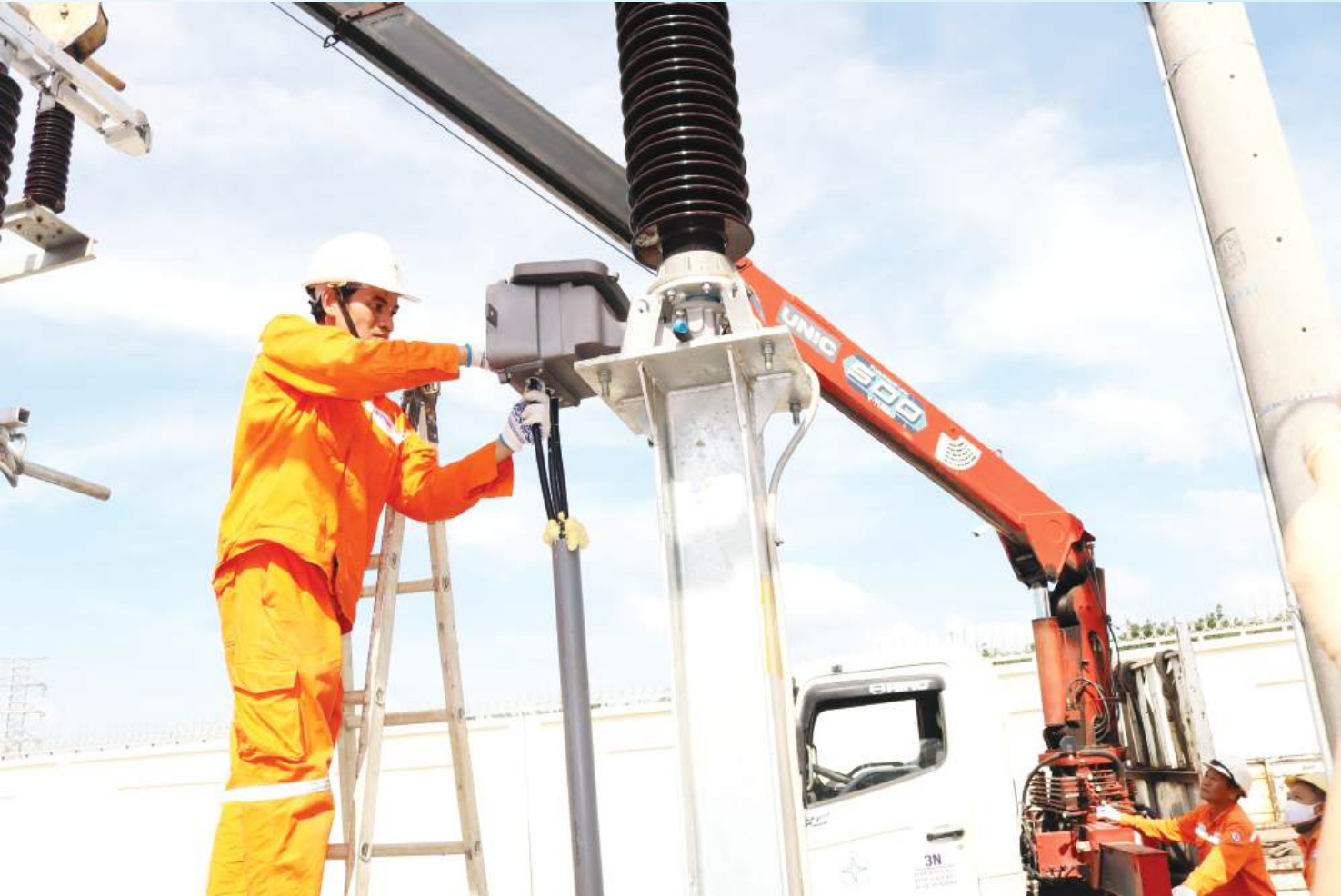
Nhân viên Điện lực Long Thành kiểm tra hoạt động hệ thống truyền tải điện nhằm đảm bảo vận hành hiệu quả, tiết kiệm điện năng trong sản xuất và sinh hoạt.
