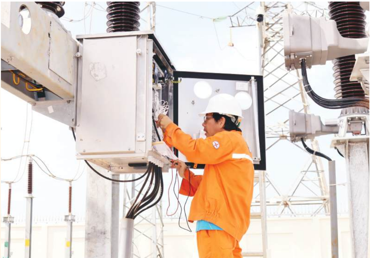
Kiểm tra kỹ thuật máy biến áp thứ 2 tại Trạm biến áp 110kV Sân bay Long Thành và đường dây đấu nối.
